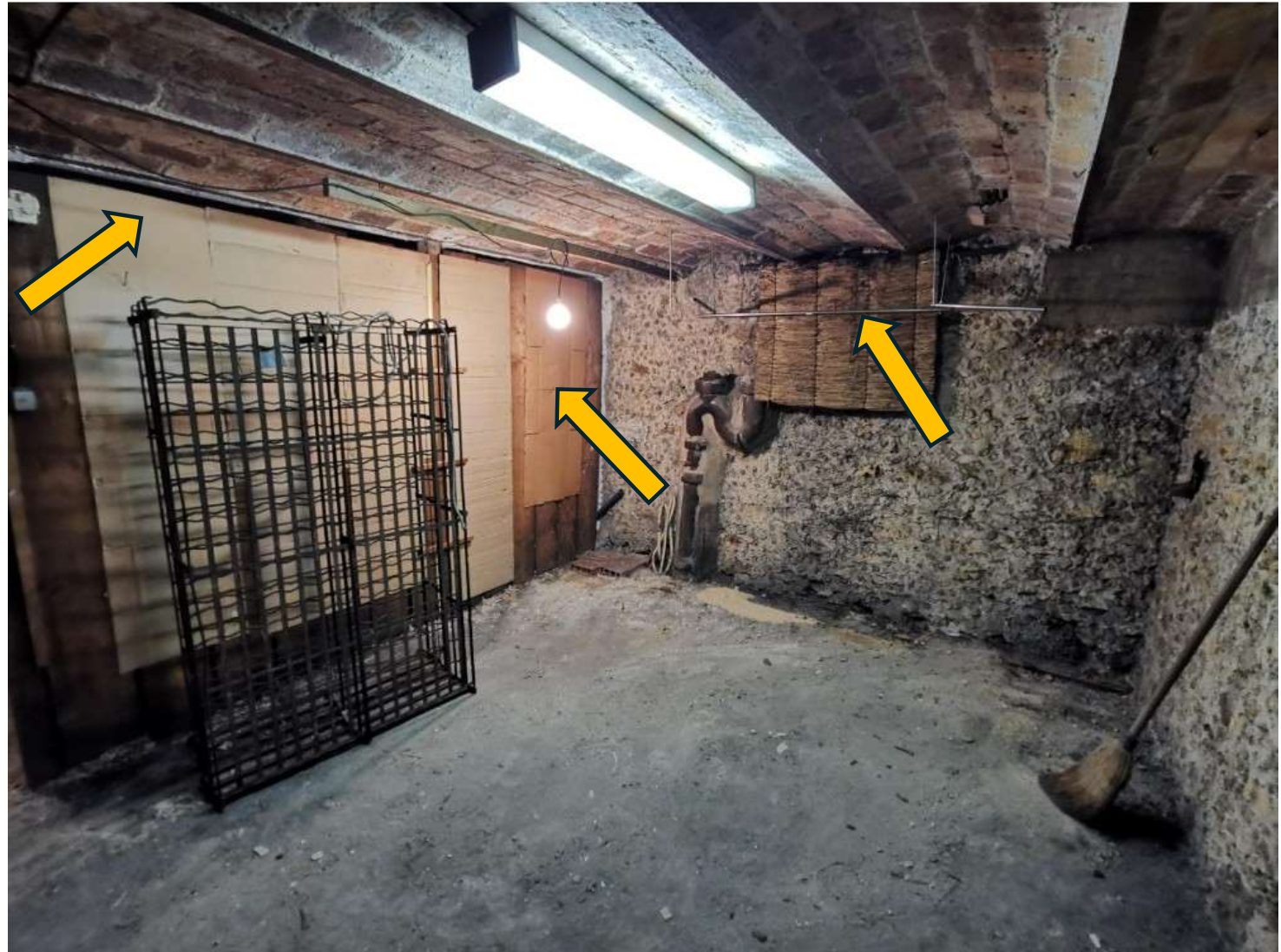
Cave avec plafond à voutains mais soupirail fermé et barbacanes bouchées par cartons
