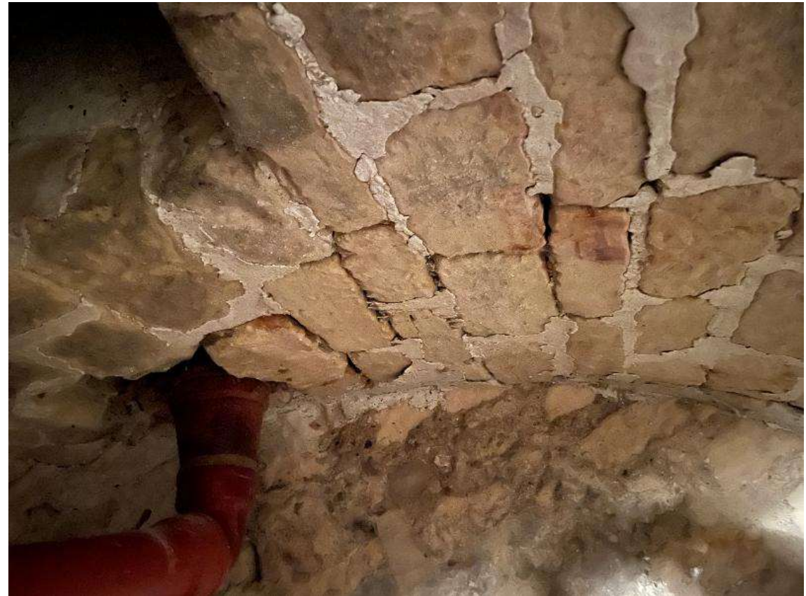
Fuites ayant déjointoyé la voûte : risque défondrement
